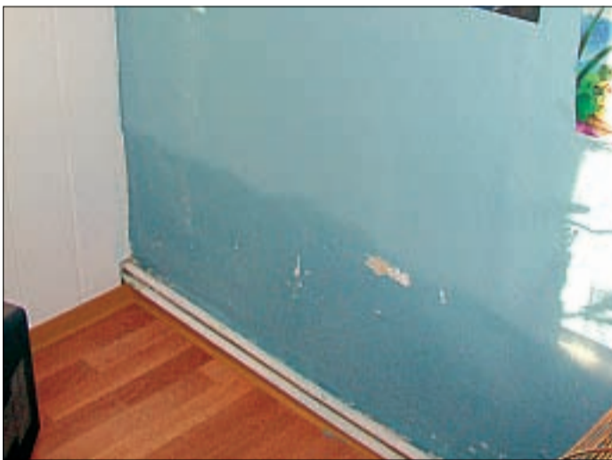
Die Nässe ist in die Innenwände gezogen.
